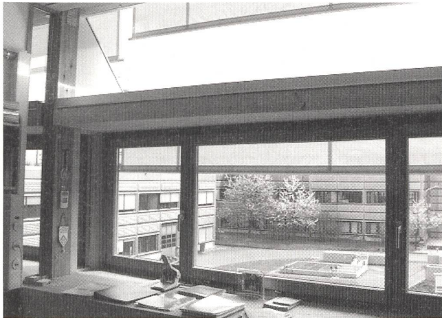
Fig. 4 Vue du système anidolique depuis l'intérieur du bâtiment
