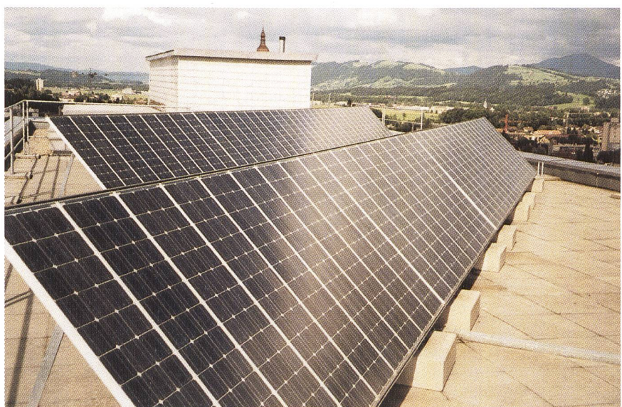
Bild 1 Photovoltaikanlage Alp Emmen, Aufständerung.
