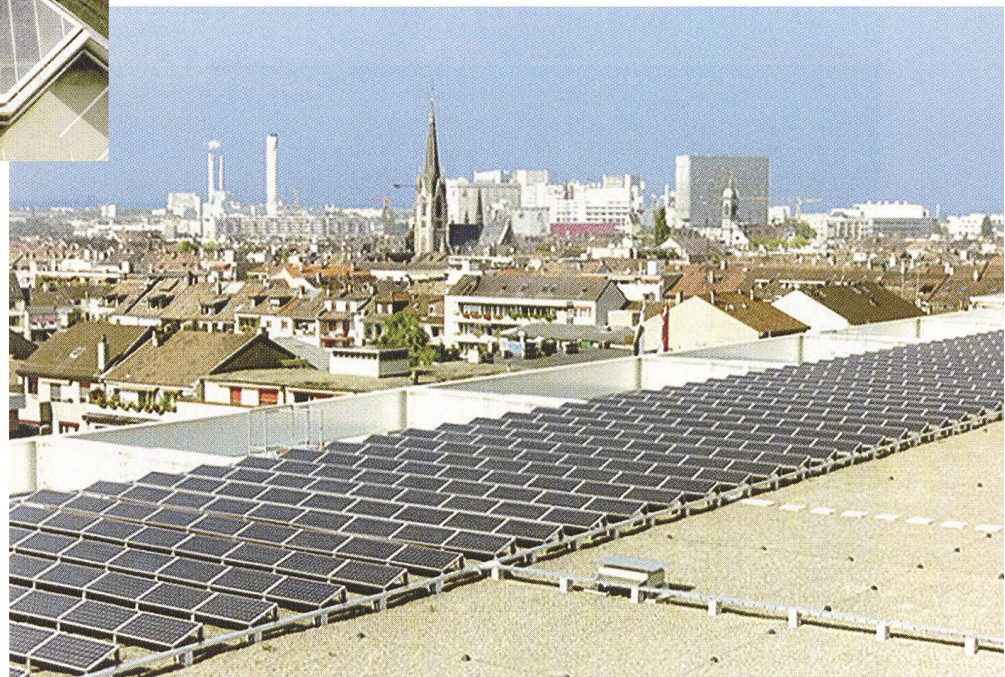
Photovoltaikanlage auf dem Dach der Messe Basel.
