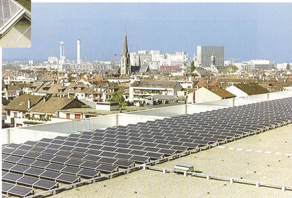
Photovoltaikanlage auf dem Dach der Messe Basel.
