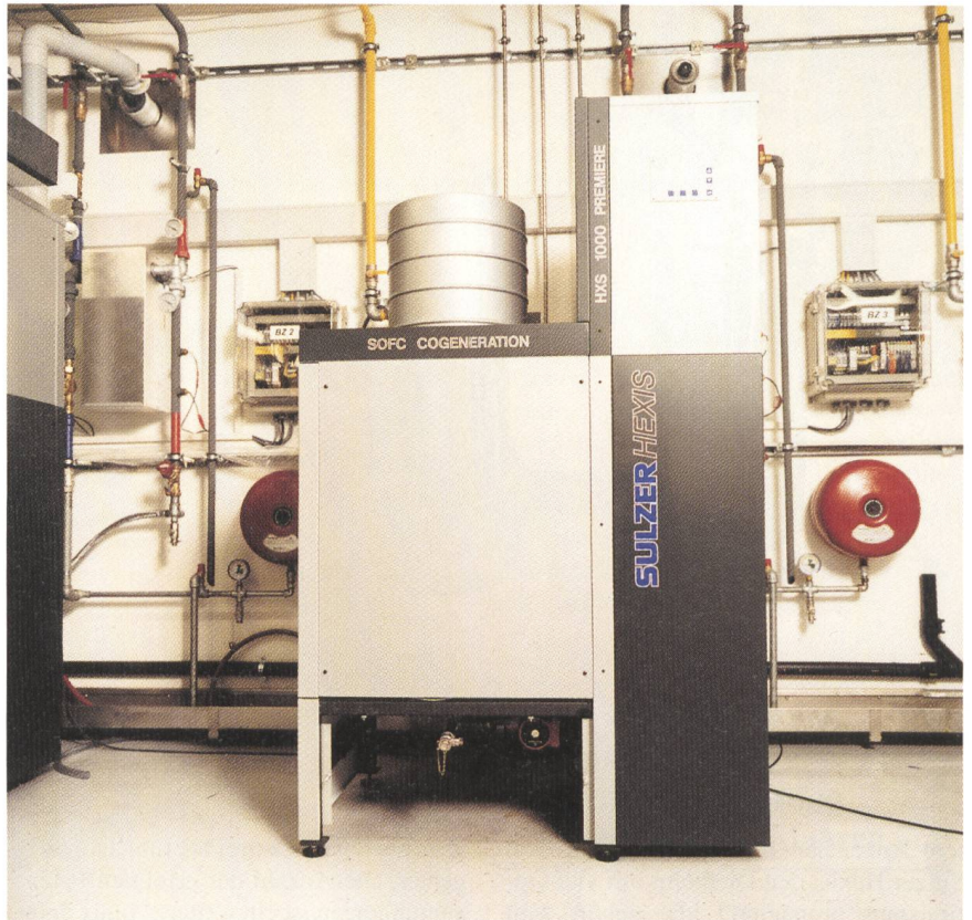
Mit dem liechtensteinischen Unternehmen Hoval entwickeltes Vorserienprodukt – bestehend aus 200-Liter-Wärmespeicher, 1-kW-Zellenstapel und Zusatzbrenner.
