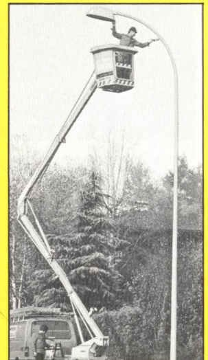
Korrosionsschutz an Stahlkandelabern
