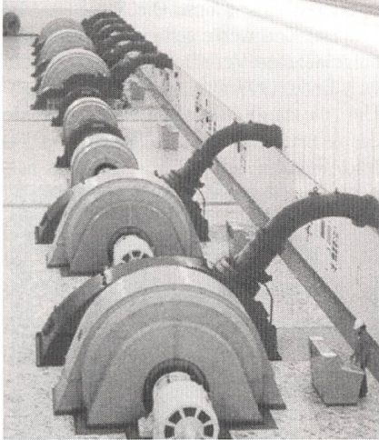
Turbinen und Generatoren in der Kaverne Tierfehd. Foto: Siemens
