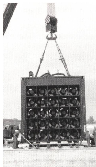
25 Kleinturbinen, angeordnet in einer 5x5-Matrix.
