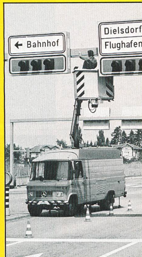
Korrosionsschutz an Signalanlagen
