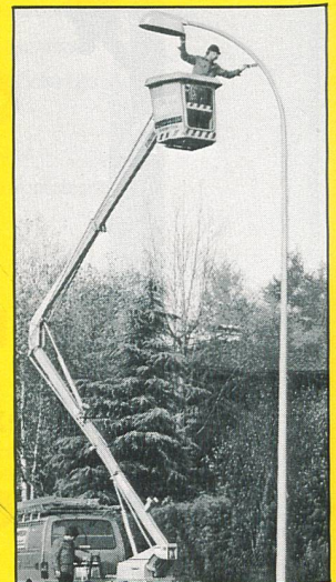
Korrosionsschutz an Stahlkandelabern
