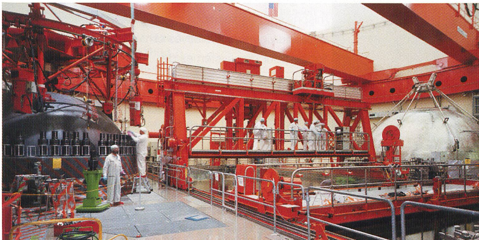
Die Sicherheit der bestehenden Kernkraftwerke ist auf dem Stand von Wissenschaft und Technik zu halten (Bild KKL).
