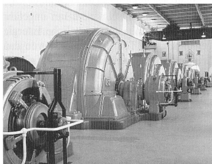
Wasserkraftwerk Küssnacht: eines der sieben Kraftwerke der AG Bündner Kraftwerke.
