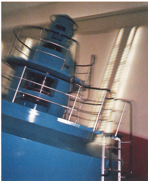
Bild 2 «Power» im Kraftwerk Göschenen (Generator/Lager).
