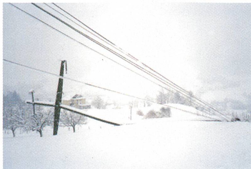
Sturmschäden auch in der Zentralschweiz (Bild CKW).
