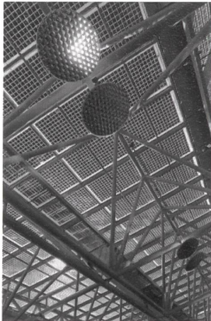
Solarstromanlage auf dem Glasdach am Migros-Hauptsitz in Zürich.
