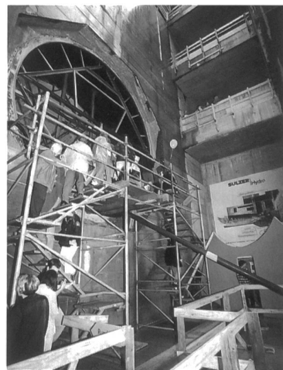
Am Tag der offenen Tür konnte der Rohbau besichtigt werden. 5,9 Meter misst die Öffnung für das Turbinenrad.
