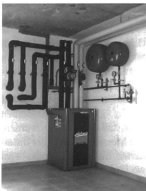
Wärmepumpe in Minergiehaus
