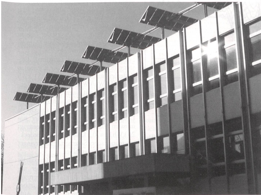
Bild 1 Die als Pergola gestaltete Photovoltaikanlage auf dem Dach des Grundlagentraktes des Neu-Technikums Buchs/SG (Foto: A. Montani).
