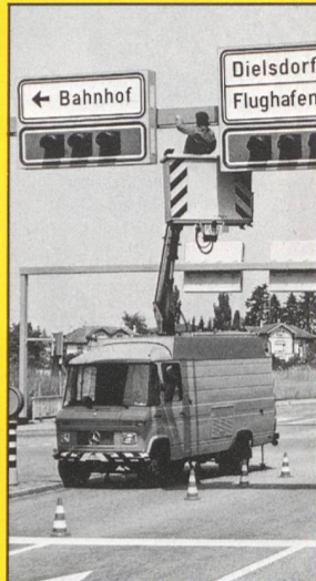
Korrosionsschutz an Signalanlagen
