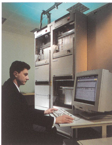
Umfassendes Network-Management für Transport und Access-Level.
