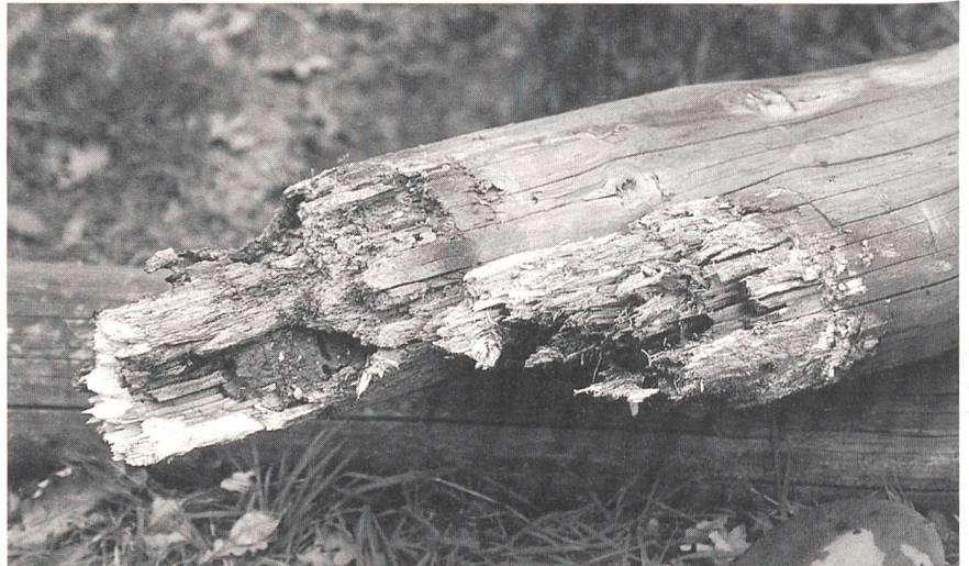
Moder- und Weissfäulepilze als Schadenursache.
