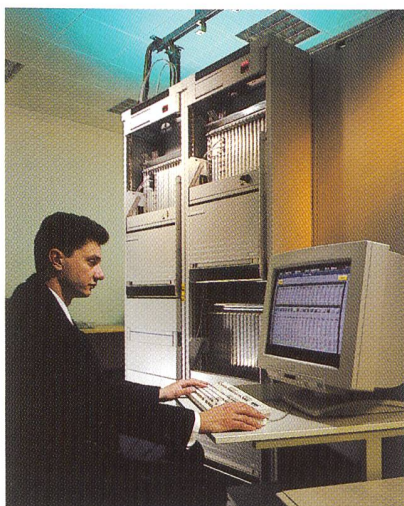
Umfassendes Network-Management für Transport und Access-Level.
