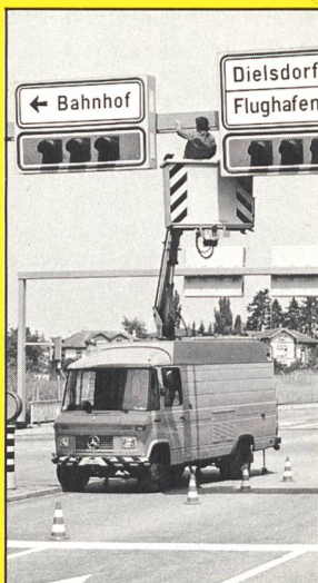
Korrosionsschutz an Signalanlagen
