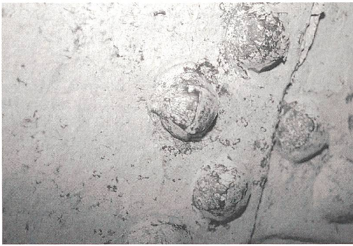
Bild 2 Nieten und die Blechstößen verursachen Wirbelungen.
