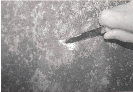
Bild 3 Die alte Beschichtung war mit einem Messer leicht entfernbar.
