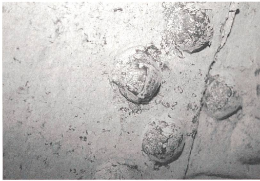
Bild 2 Nieten und die Blechstößen verursachen Wirbelungen.
