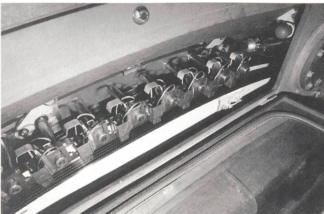
Bild 4 Blick in die geöffnete Schleifringkammer. Im Stillstand werden die Bürstenbrücken pneumatisch vom Schleifring abgehoben.
