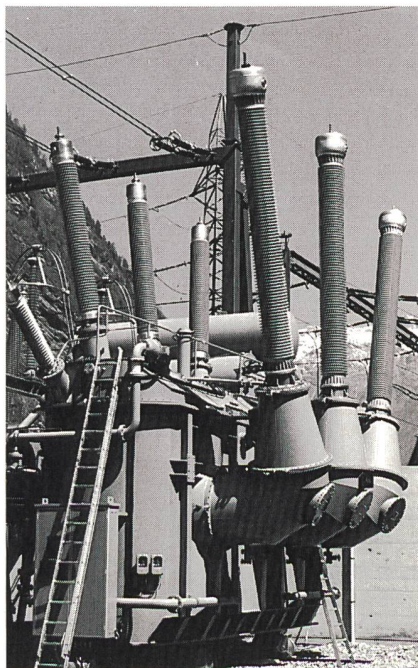
Bild 10 Verbundisolatordurchführungen an 420/220-kV-Leistungstrafo
