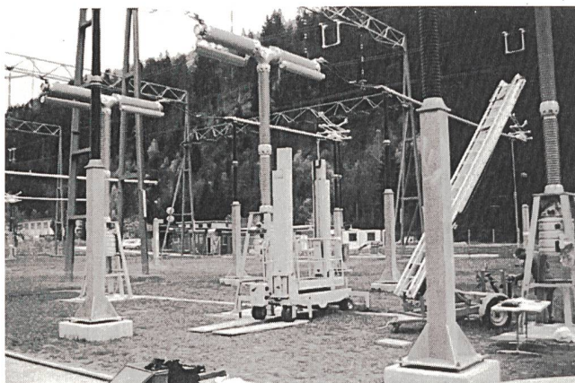
Bild 15 420-kV-63-kA-Leistungsschalter und Steuerkondensatoren mit Verbundrohrisolatoren
