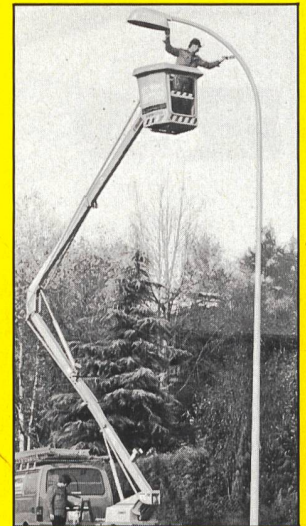
Korrosionsschutz an Stahlkandelabern
