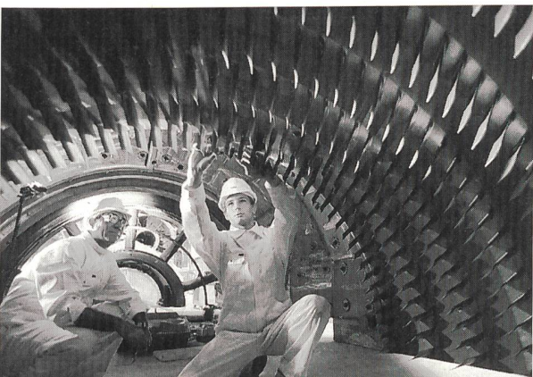
Neues ABB-Gasturbinen-Prüfzentrum in Birr: Kompressorschaukelträger für die GT26.
