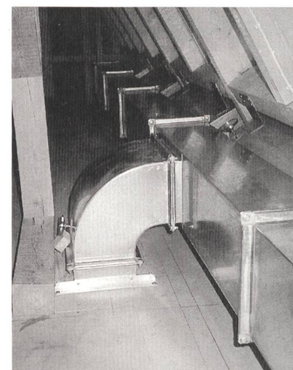
Bild 3 Heissluft-Sammelkanal nach Luftkollektoren.
