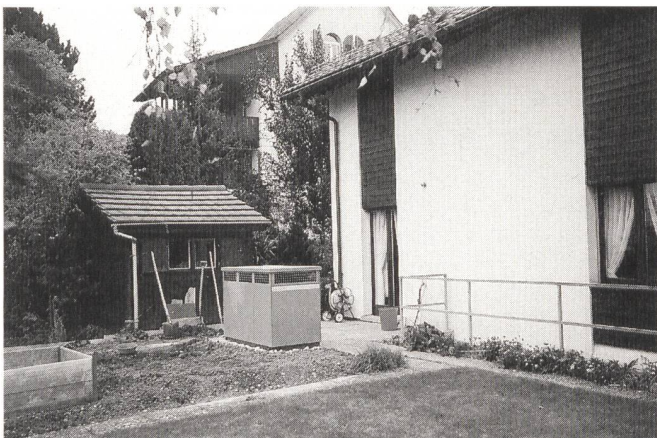
Bild 1 Monovalente Luft-Wasser-Wärmepumpe in Aussenaufstellung (links) bei einem Einfamilienhaus in Seuzach ZH (Fotos: EKZ).
