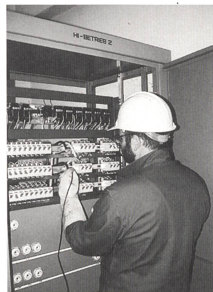
Bild 3 Sicheres Arbeiten an und in der Nähe von Niederspannung.
