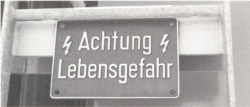
Bild 6 Permanent montierte Warntafel am Aufstieg eines Transformators: «für den Laien von Bedeutung, der Fachmann sieht sie nicht (mehr)».
