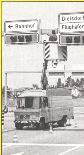
Korrosionsschutz an Signalanlagen
