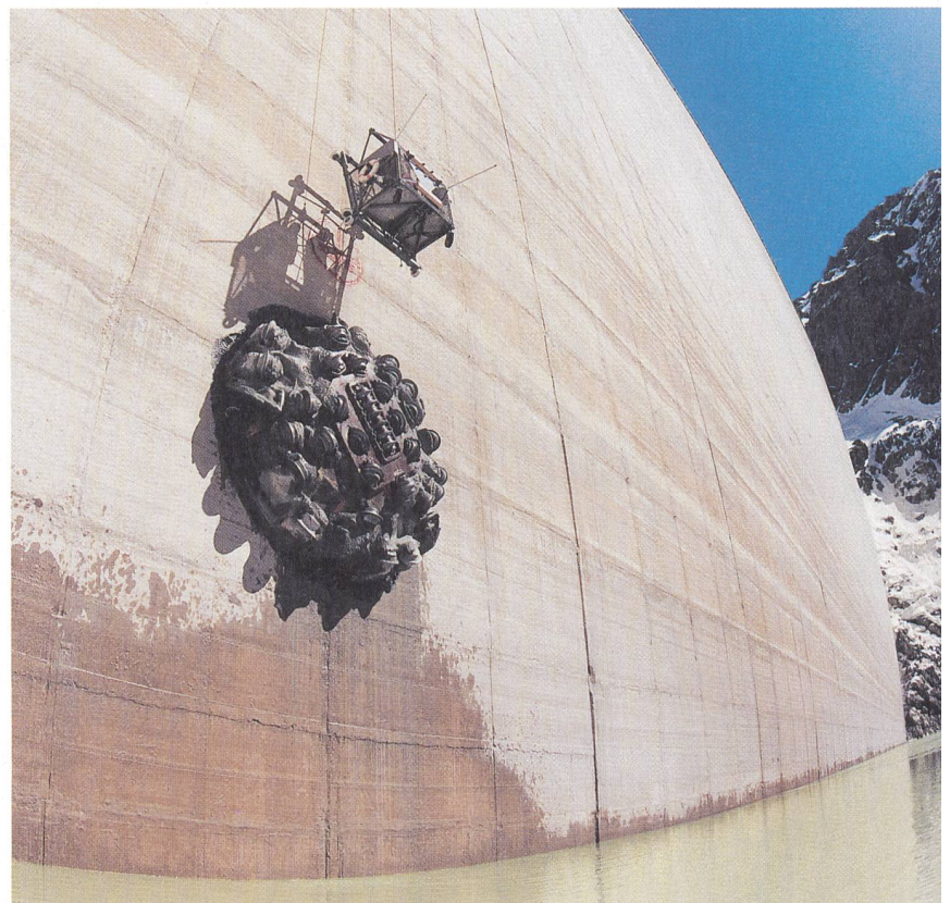
Percement du mur du barrage de Grande Dixence pour la prise d'eau menant à la nouvelle centrale de Bieudron (aménagement Cleuson-Dixence, VS).
