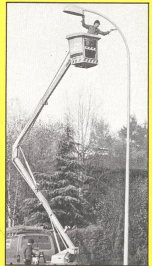
Korrosionsschutz an Stahlkandelabern
