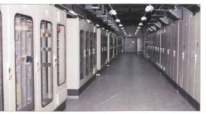
KONTROLLIERT DAS INNENLEBEN: Schnittstelle aller Signale und Befehle mit unzähligen Schalt- und Steuerungs-Schrank.
