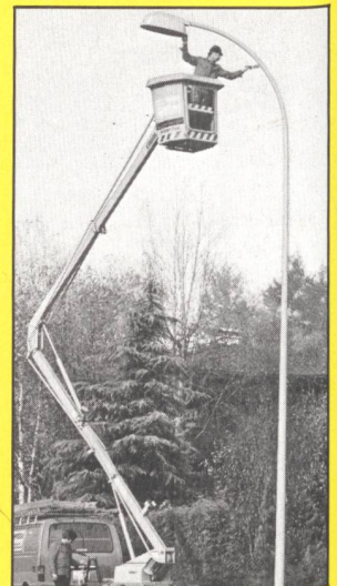
Korrosionsschutz an Stahlkandelabern
