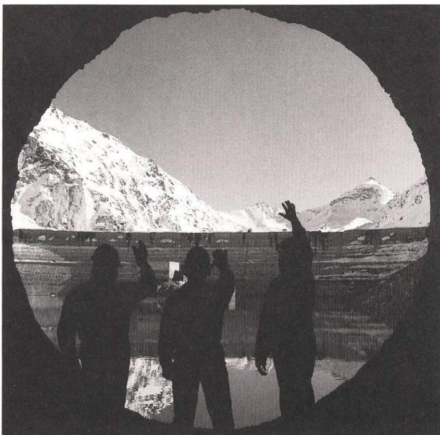
Vue du mur de l'ancien barrage depuis la nouvelle prise d'eau avec ouvriers au premier plan.
