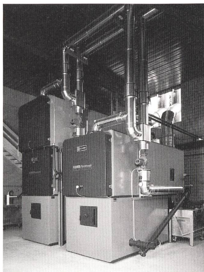
Bild 10 Mit Restholz Heizöl und Erdgas substituieren: Schnitzelfeuerungen in der Sägerei Aecherli in Regensdorf (Foto: Aecherli).
