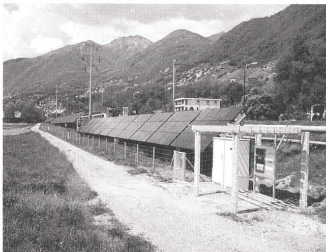
Bild 13 Strom vom Bahndamm: Photovoltaikanlage in Riazino (Foto: TNC-Consulting).
