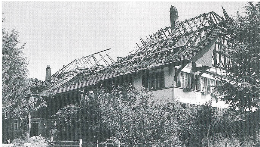
Weitgehende Zerstörung des Bauernhauses
