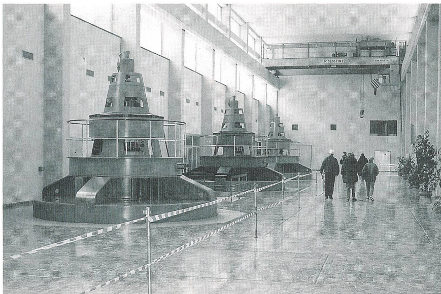
Besichtigungsrundgang durch die Maschinenhalle in Pradella
