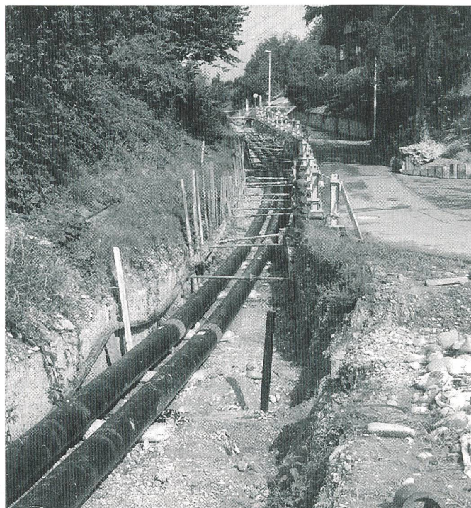
Mit Wärmetransportleitungen wird die Abwärme zu den Wärmebezüglern der Refuna transportiert
