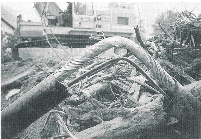
Die schweren Baumaschinen, die in Brig zum Wegräumen des Geschiebes im Einsatz waren, beschädigten einige Kabelleitungen
