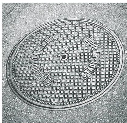
Bild 6 Dort wo sich unterirdische Kabelwege kreuzen, wurden einst die für den Kabelnachzug nötigen Schächte durch besondere, mit Elektrizitätswerk-Namen und Stadtwappen gekennzeichneten Gussdeckel, verschlossen (Zürich)
