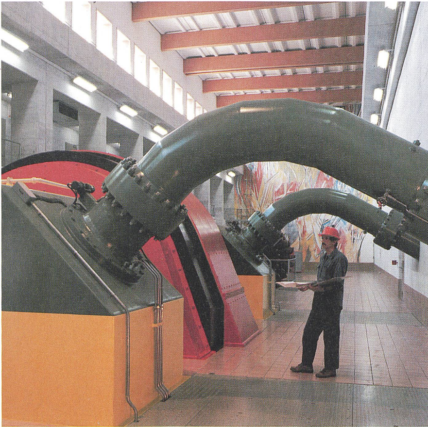
Maschinengruppe der neuen Stufe Panix (Zentrale Ilanz, Bild NOK).
