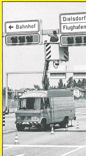
Korrosionsschutz an Signalanlagen
