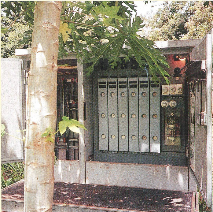
Kabelverteilkabine Gr. II, TV-Typ C
