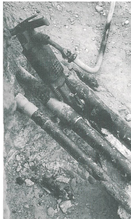
Unfallstelle mit Presslufthammer in Betonrohblock und 10-kV-Kabel
