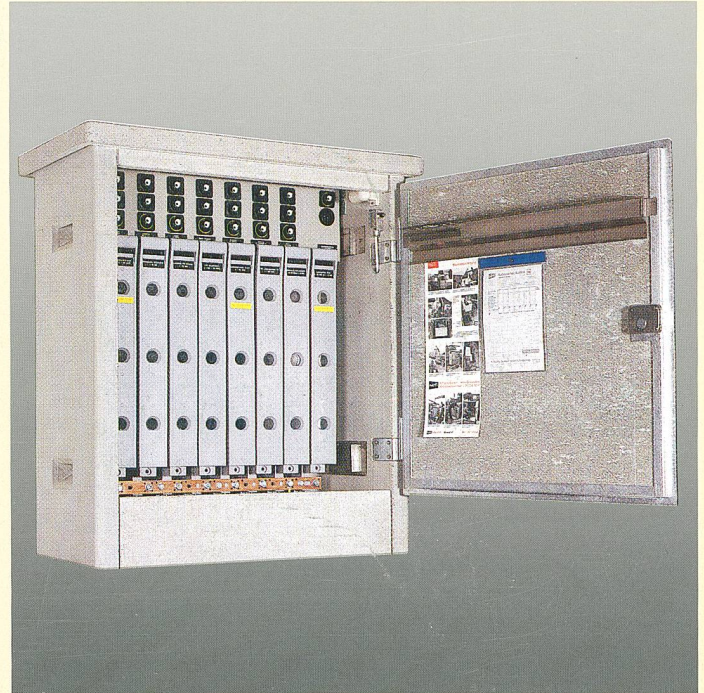
Kabelverteilkabine Gr. I, freistehend
