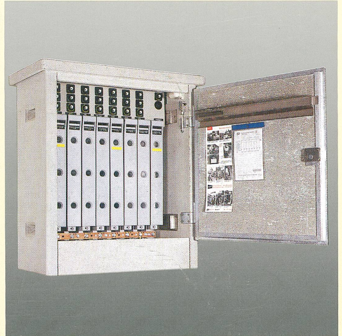
Kabelverteilkabine Gr. I, freistehend
