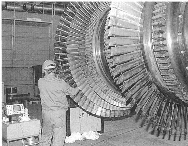
Nach mehr als 22 Betriebsjahren befinden sich die Turbinen des Kernkraftwerks Beznau in einem ausgezeichneten Zustand. Ein Mitarbeiter der Erbauerfirma Brown Boveri (ABB) nimmt Prüfungen an einer Niederdruckturbine vor
