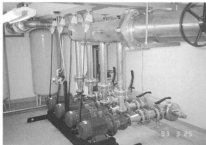
Station de pompage pour le réseau Révalpie
