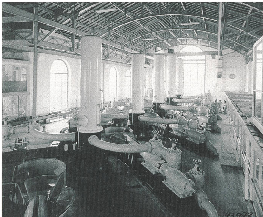
Photo 3 La salle des pompes de la centrale hydroélectrique, La Coulouvrenière, lors de son centenaire célébrée en 1986. Ces pompes étaient entraînées par des turbines Fontaine (type Jonval amélioré) construites par Escher Wyss
