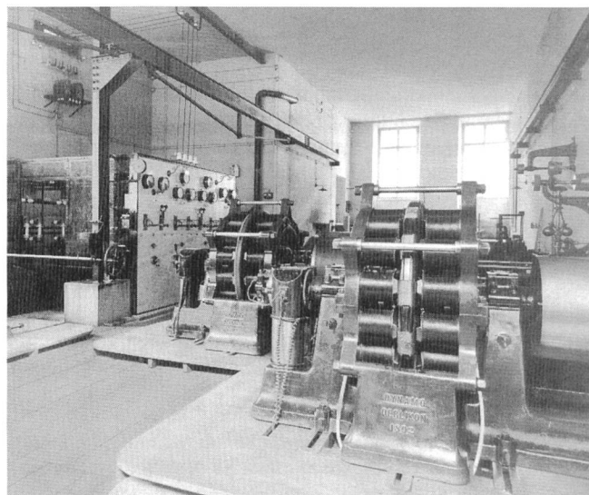
Die ersten Generatoren mit Baujahr 1892 in der alten Zentrale Meiersboden
