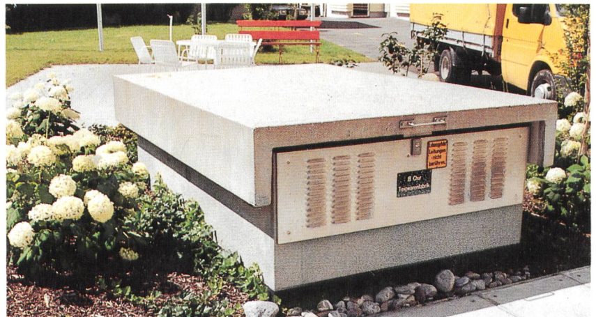
Fertig-Transformatorstation, Typ: Unterflur C
