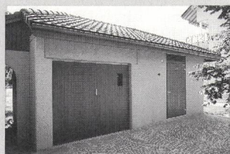
Trafostation mit Anbau
