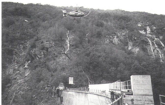
Bild: Ablegung eines der 35 L-förmigen Elemente (4,3 Tonnen) auf der Krone der Staumauer Vasasca Foto: Posa di uno dei 35 elementi a «L» del peso di circa 4,3 t sulla corona della diga Vasasca (Foto: Massimo Pedrazzini)
