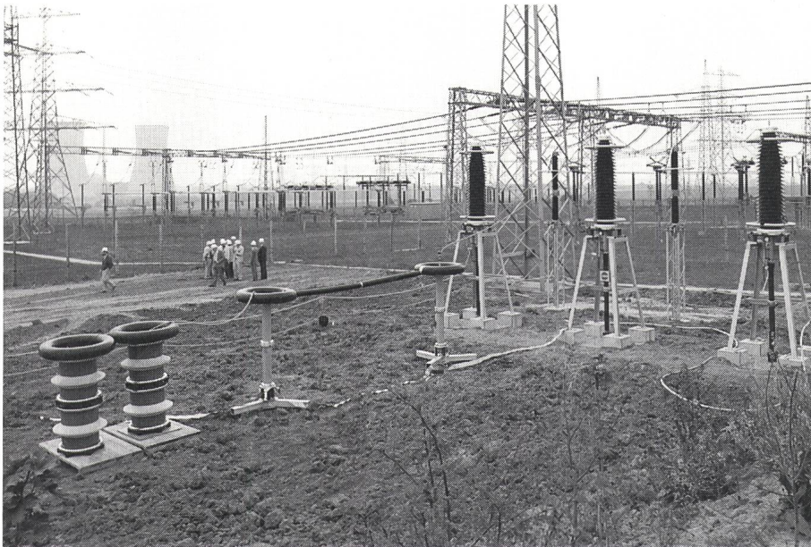
Bild 5 Vor-Ort-Wechselspannungsprüfung einer 220-kV-VPE-Kabelanlage Von rechts nach links: Drosselspulen in Serieparallelschaltung ( L_{total} = 50 H), Spannungsteiler, Belastungskapazität, Porzellanendverschlüsse.
